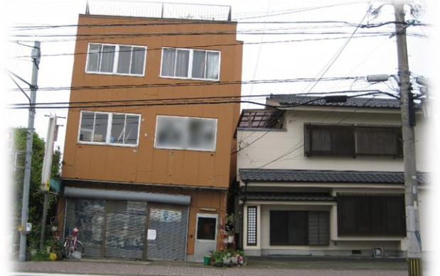
写真a 液状化により傾いた建物(図b A点付近)
